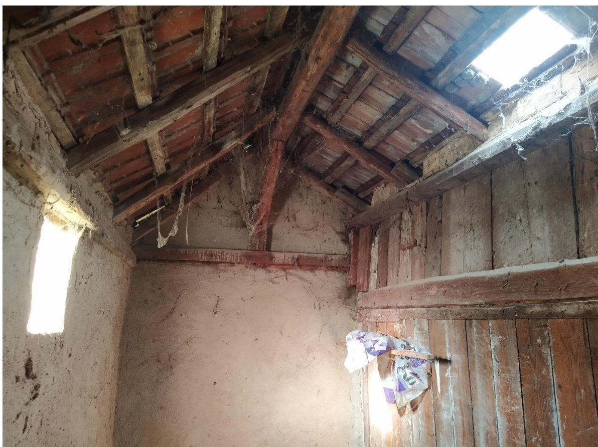
Abb. 4: In diesem Gartenschuppen konnte einmalig Fledermauskot festgestellt werden.
